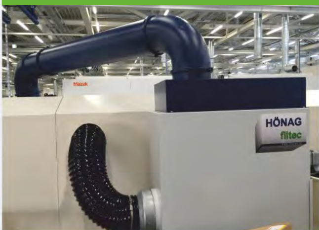
Absaugung und Rückführung an offener Rundschleifmaschine
